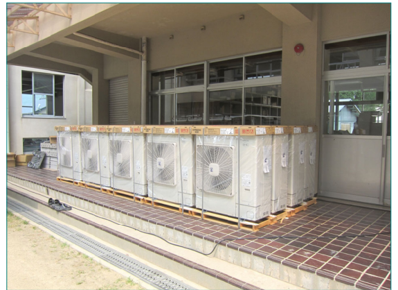
廊下に並ぶエアコンの室外機
